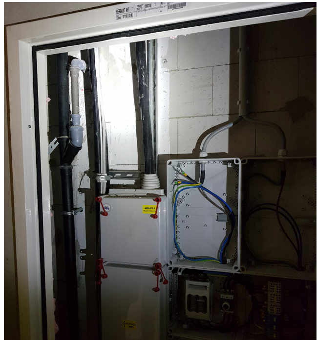
2. ÁBRA: TERVEKNEK MEGFELELŐEN MEGSZERELT GÉPÉSZETI ÉS VILLAMOS SZERELŐAKNA
