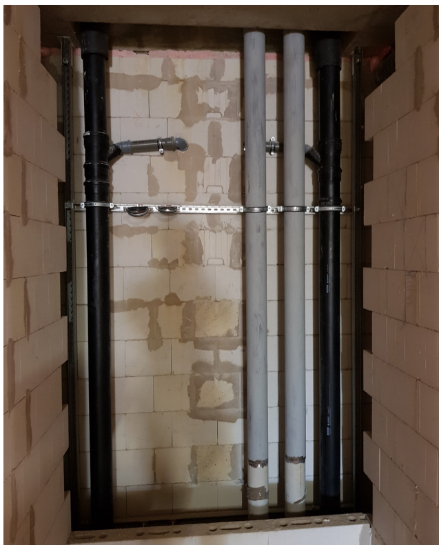
3. ÁBRA: HAGYOMÁNYOS MÓDSZER SZERINT SZABÁLYOSAN KIVITELEZETT GÉPÉSZETI SZERELŐAKNA
