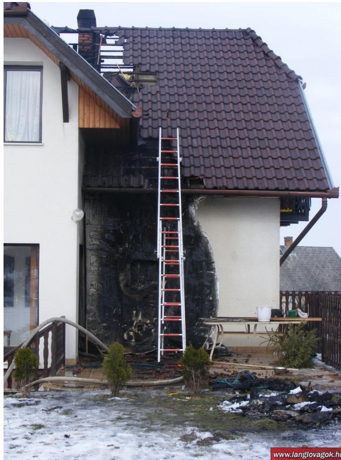
4.8. ábra – Villanyóraszekrény tüze miatt kiégett tetőszerkezet
