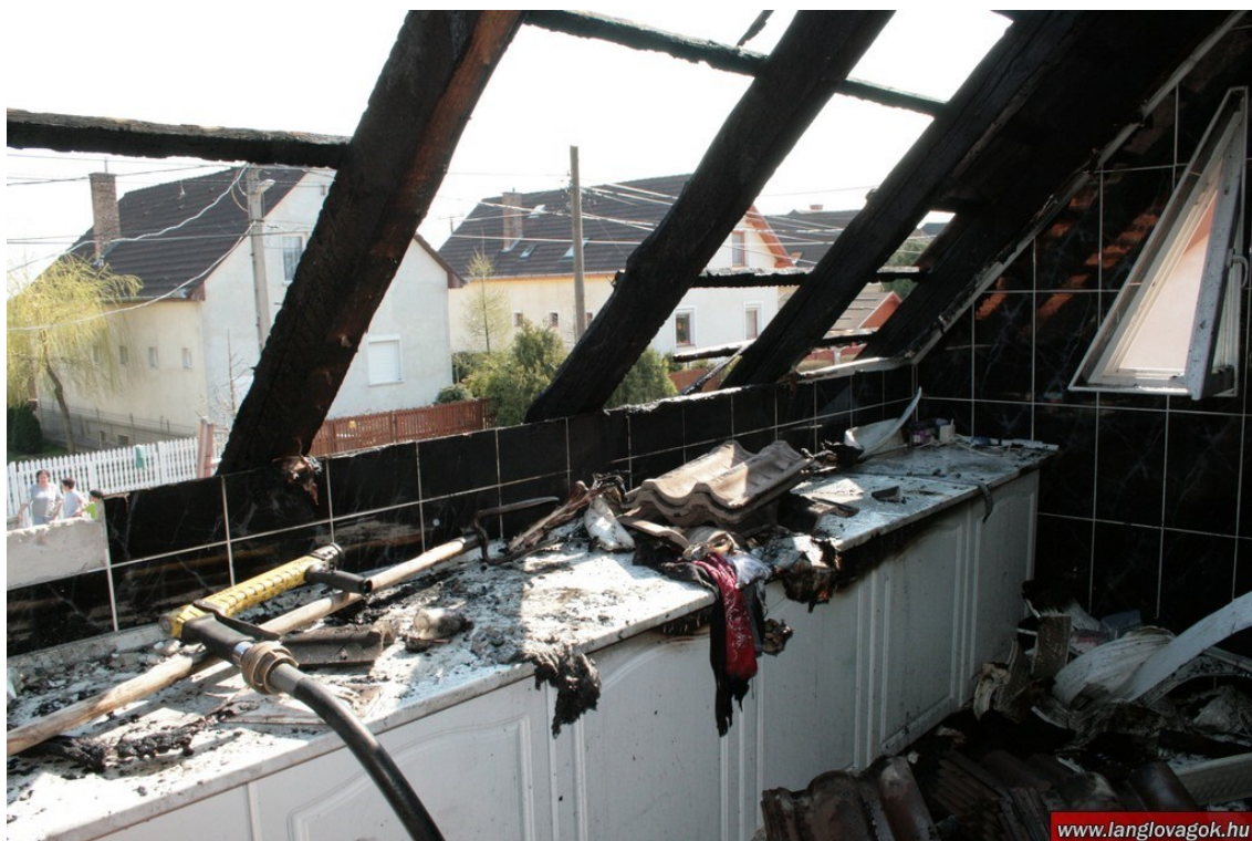
4.6. ábra – Kiegett fürdőszoba. A beépített tetőtér belső burkolata teljesen megsemmisült (forrás: www.langlovagok.hu )
